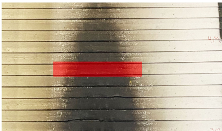
Figur 5-5 Viser vurdering av skadet område, skadet område markert i rødt.
